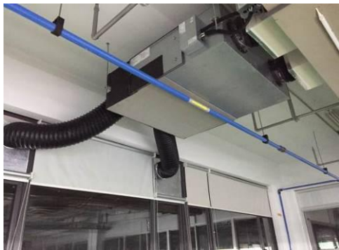
新风设备保证室内空气质量
