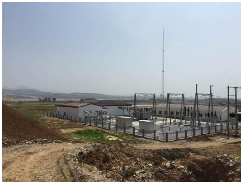
升压站远观图
