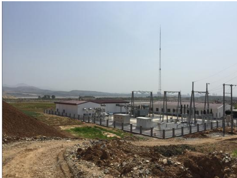
升压站远观图
