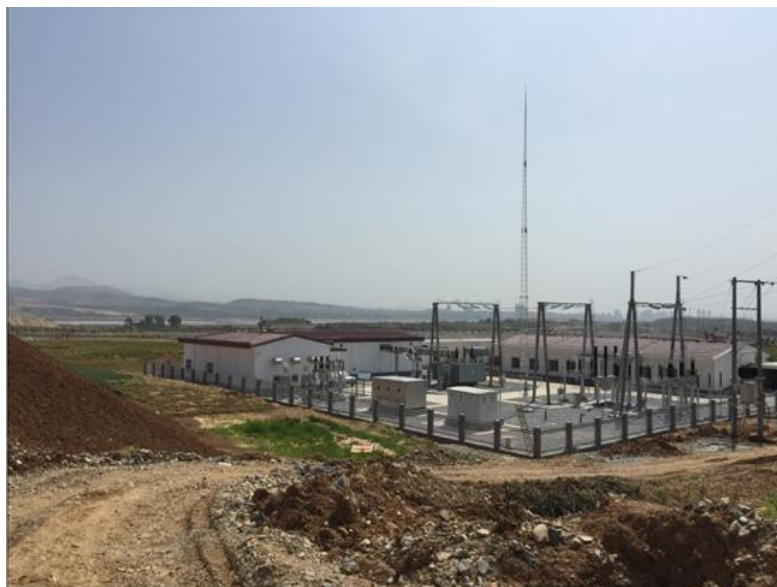
升压站远视图
