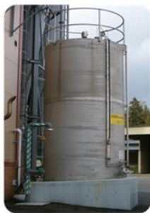
还原剂储存单元 RTU
