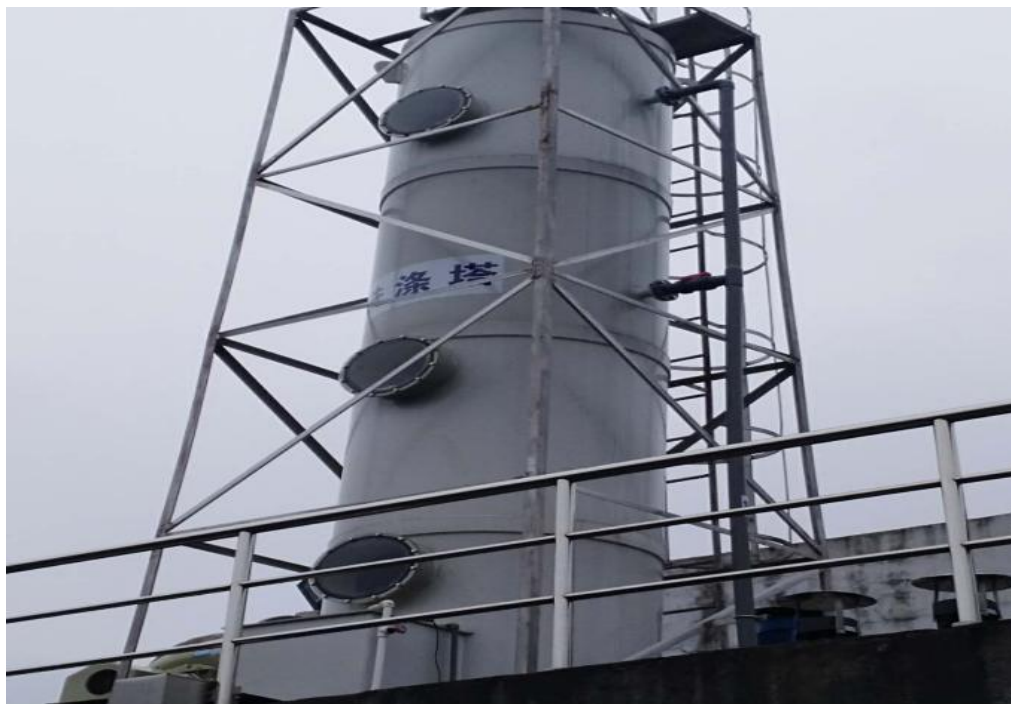
污水处理车间增加一台尾气处理系统,全面处理污水处理车间异味气体的排放
