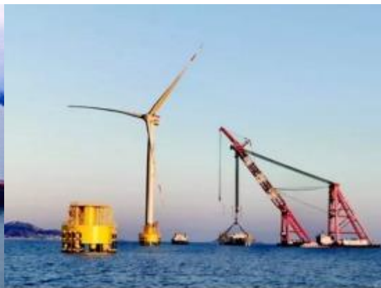
图 8. “亨通一航”号海上风电作业平台
