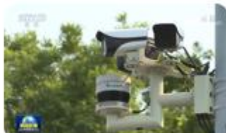
路侧智慧基站
