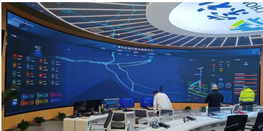
智慧路灯大数据智慧驾舱,与前端智慧设备实时联动 7*24 小时 AI 监控, 华体科技助力 2022 北京冬奥会(崇礼赛区)指挥中心应急决策
