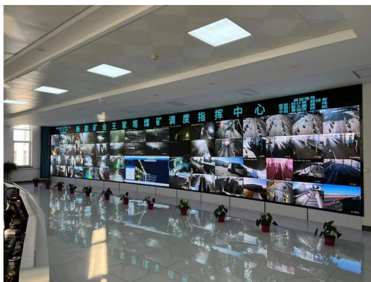
图 3：新能矿业王家塔煤矿调度指挥中心
