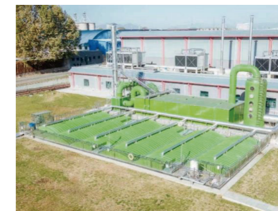
露天污水处理设施
