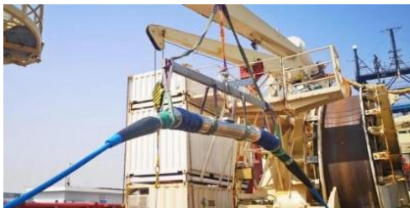
图 17 全球首个 16 纤对中继海底光缆系统
