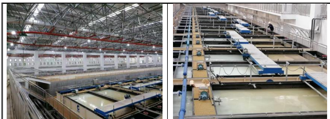
昆明市第七、八水质净化厂超极限除磷提标改造项目（现场实景）
