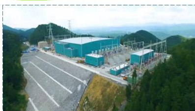
渝鄂柔直工程换流站
