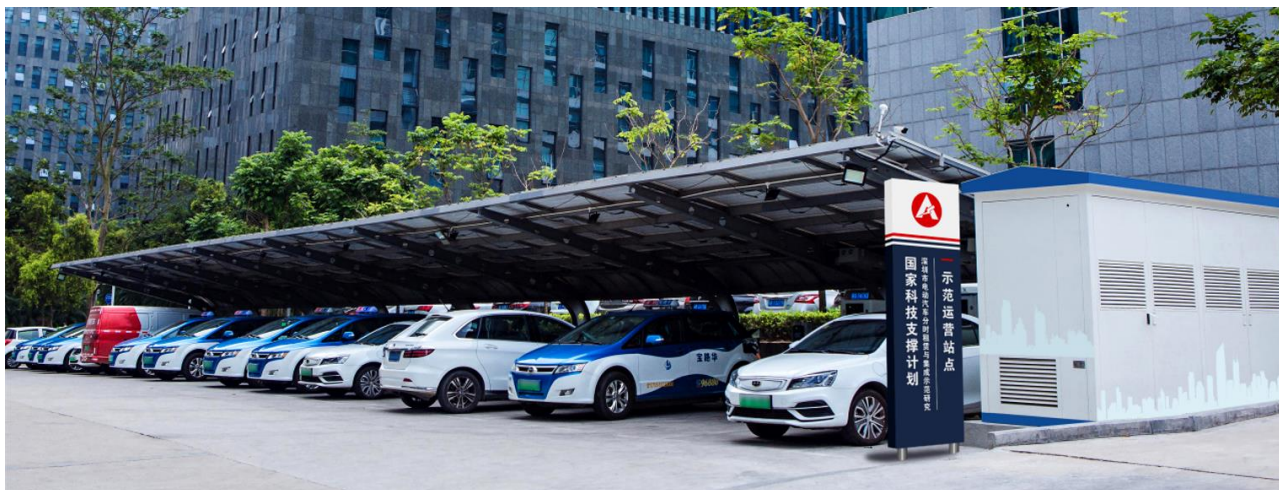
注：图为电动汽车集约式柔性公共充电示范站
