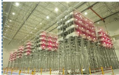
张北柔直工程换流阀厅
