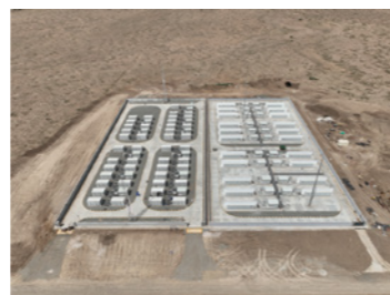
储能项目基地
