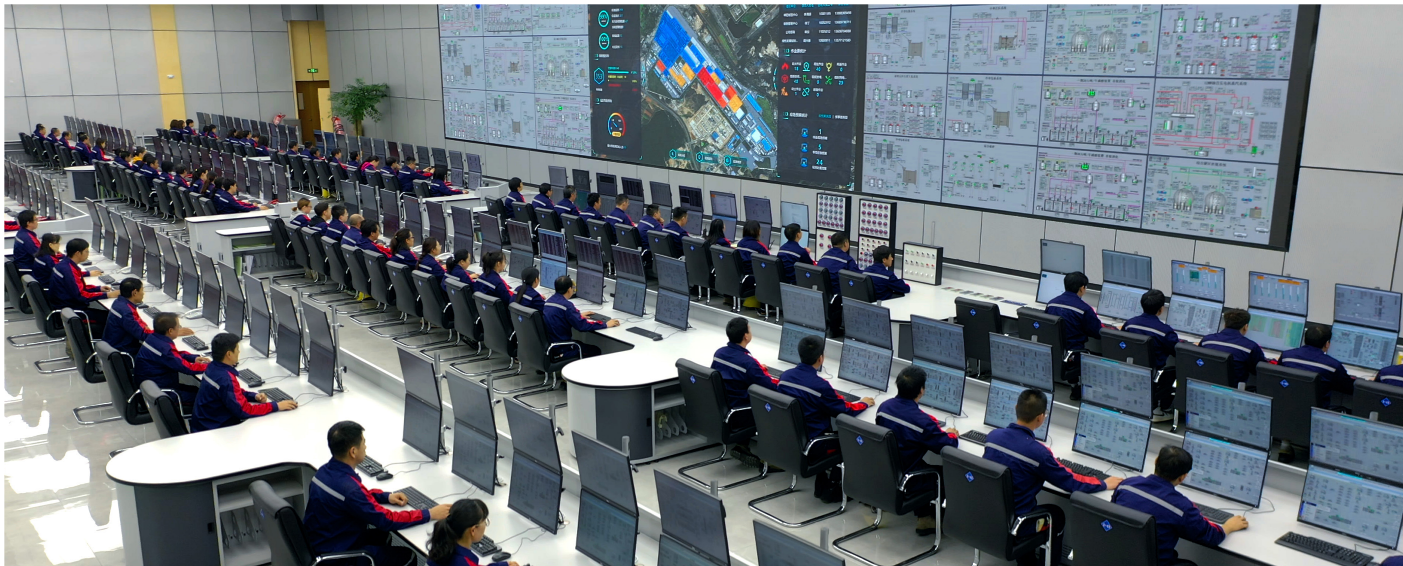
图: 天安化工集中控制室
