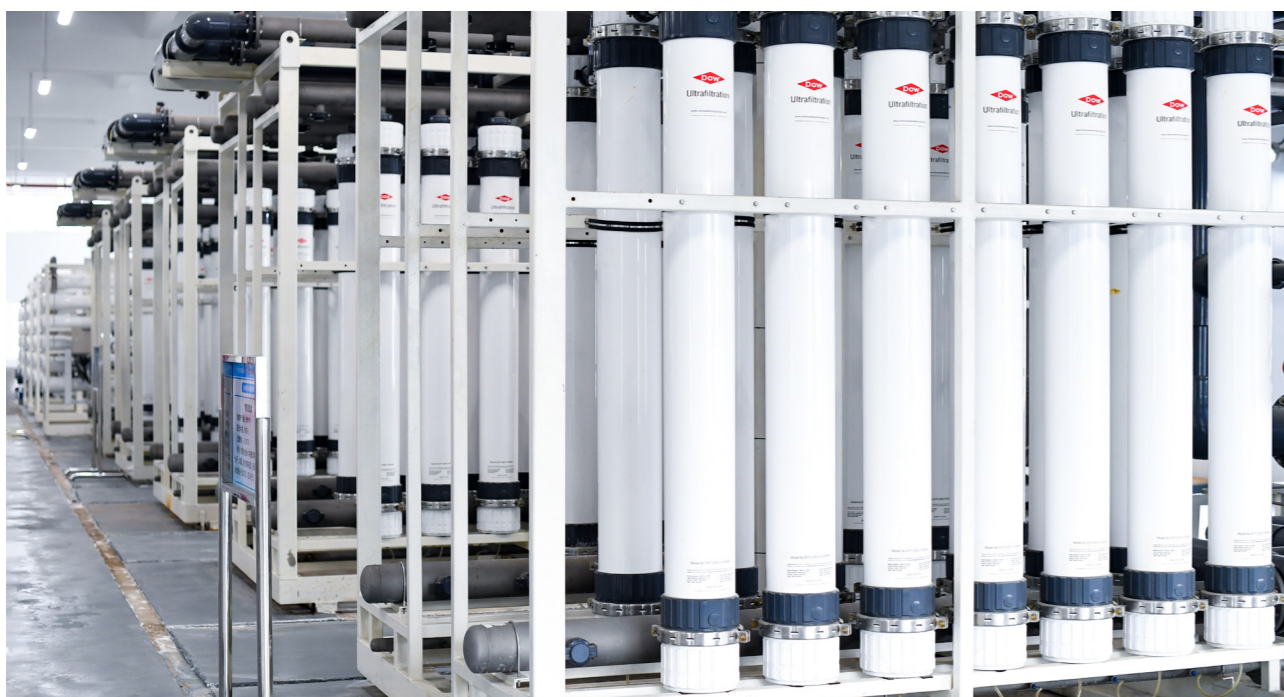
图：水富云天化废水资源化利用减排装置（膜处理）
