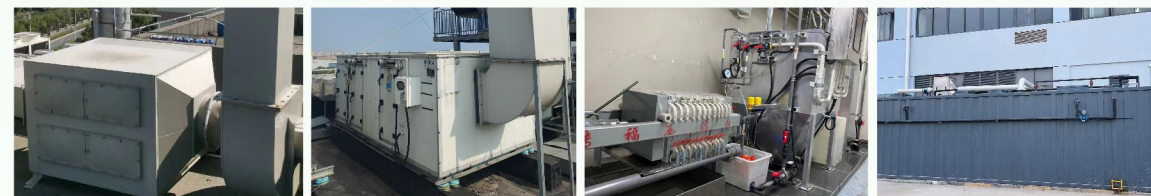
废水、废气治理设施图片
