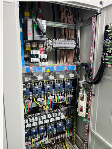
针对安全生产风险对厂区变电箱安全情况进行取证
