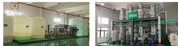
中水回用处理设施
