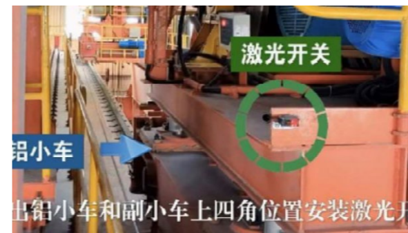
小车激光开关安装位置
