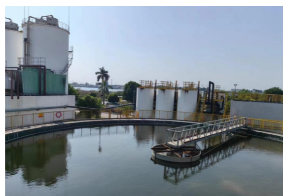
南沙公司污水站
