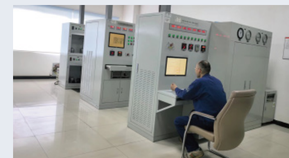
高效节能压缩机重点实验室
