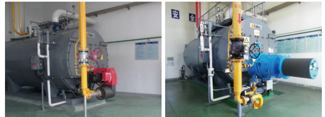
锅炉低氮燃烧改造前
