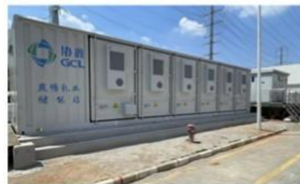
2.5MW/4.48MWh的储能电站
