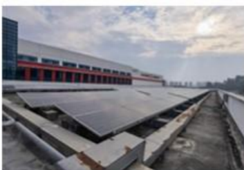
黄埔旗舰工厂建筑光伏一体化
