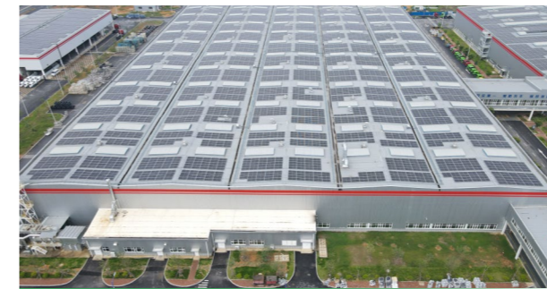
一汽解放柳州厂光伏发电项目
