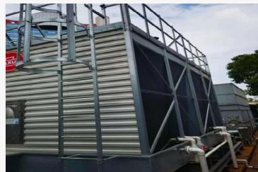
改造后的节能型冷却塔
