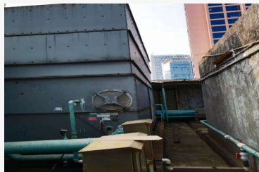
改造前的高能耗冷却塔
