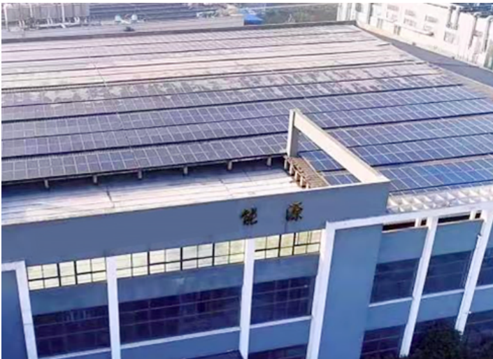
铝材料供应商屋顶安装光伏
