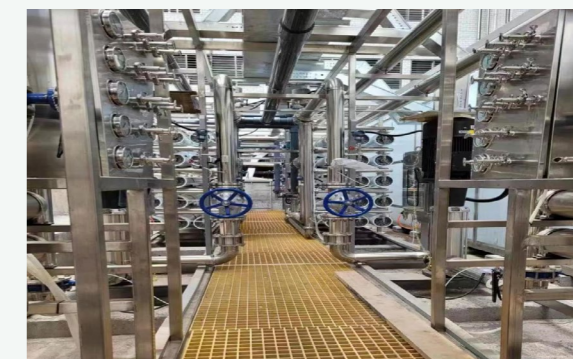
改造后的锅炉水处理车间
