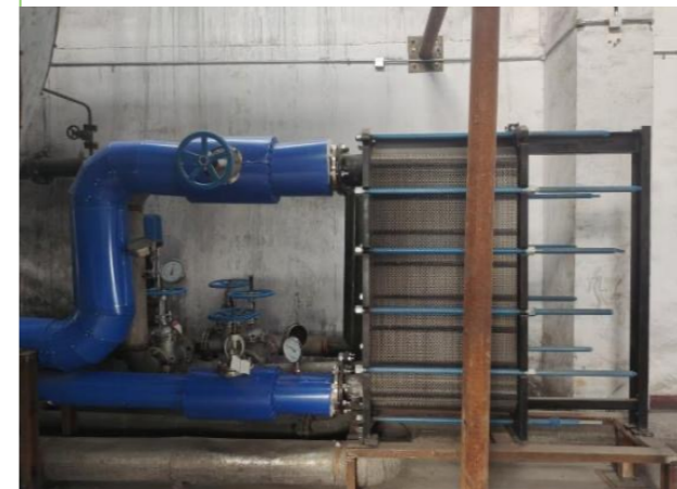
山东中茂锅炉定排连排水热回收项目
