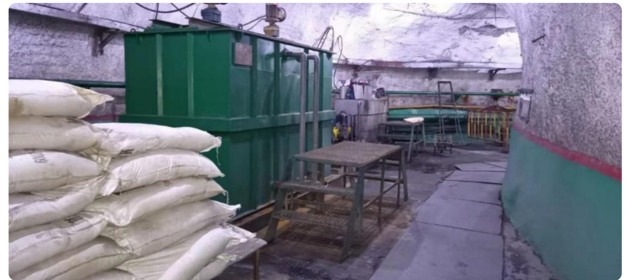
井下矿井水处理站
