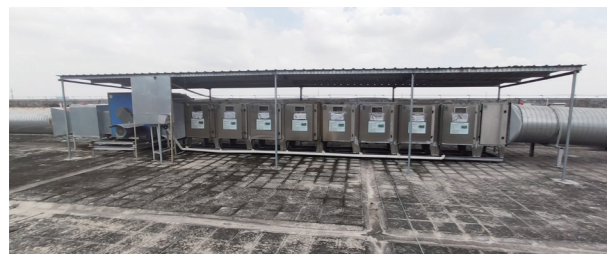
升级改造前的废气治理设施
