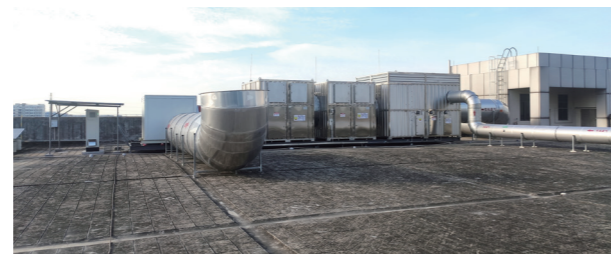
升级改造后的废气治理设施
