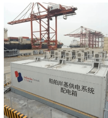
船舶岸基供电系统使用“环氧浇注多绕组变压器”
