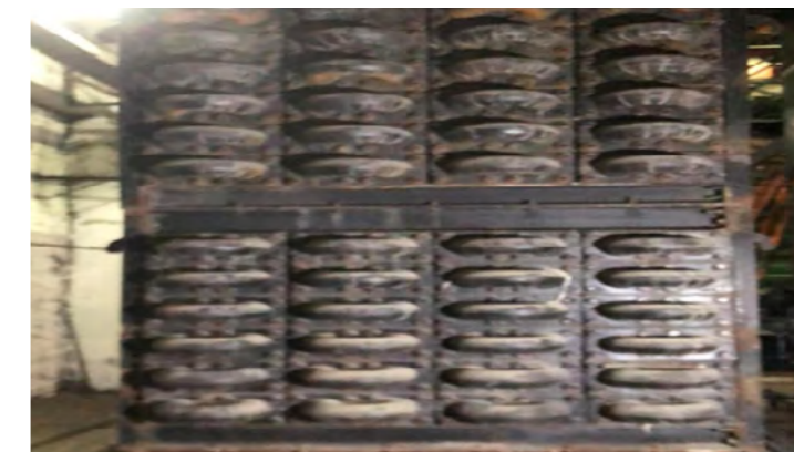
锅炉上安装的省煤器
