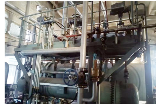
氯碱公司利用电石石灰窑导热油余热制蒸汽，解决车间用汽问题
