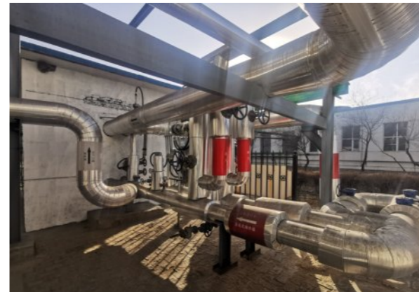
钠业公司利用氯酸钠余热代替蒸汽气化液氯，大幅节约能源消耗
