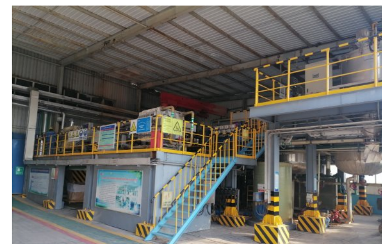
含铬盐泥表界面调控晶体生长脱毒及资源化处置设施
