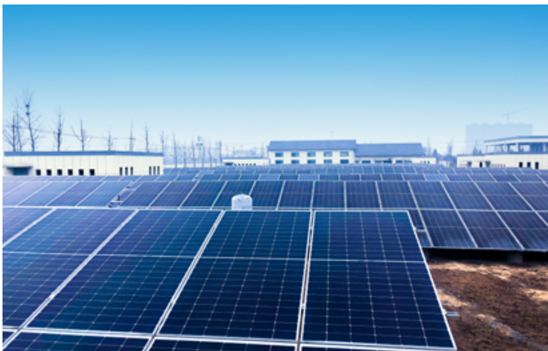
沛县第二地表水厂分布式光伏发电
