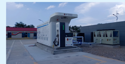
北京市首座具备70MPa加氢能力加氢站——国家电投延庆园70MPa加氢站(冬奥会配套加氢站)
