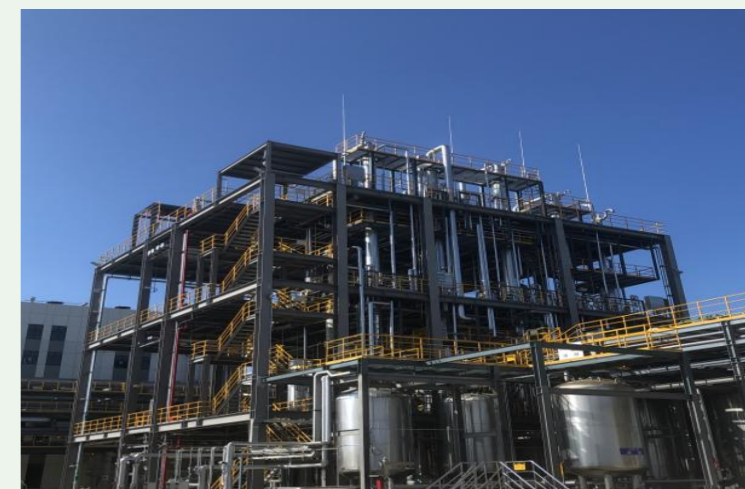
▲溶剂回收装置
