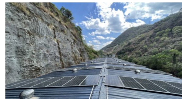
首个水电站屋顶分布式光伏项目并网发电
