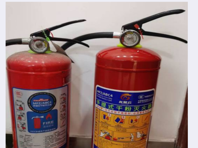
及时罐装打压，每月点检一次灭火器
