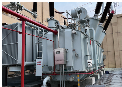
220kv主变项目现场服务
