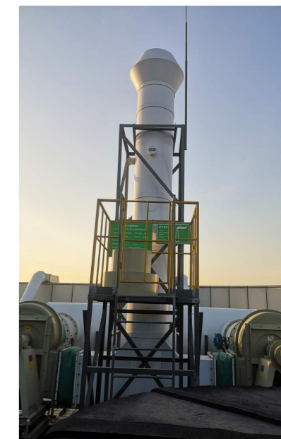
废气处理设施
