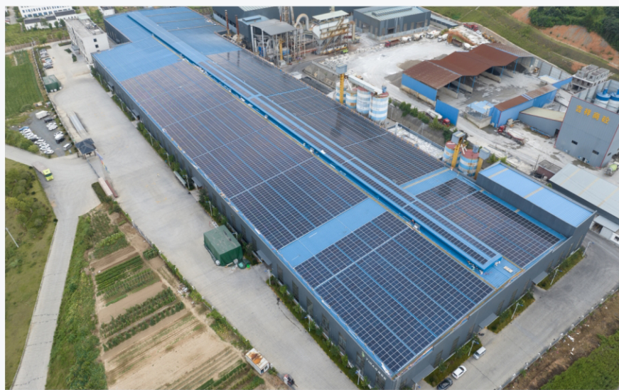
宁国恒基伟业建材有限公司3.6兆瓦光伏发电项目一期
