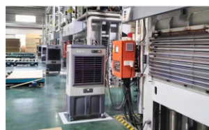
兔宝宝家具板公司在生产车间安装冷风机防暑降温生产
