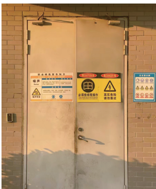
苏州捷力发电机室安全提示
