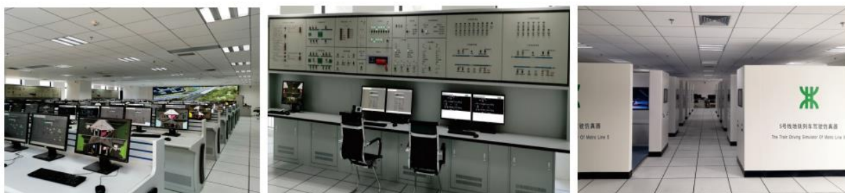
深圳地铁深云车辆段实训基地
