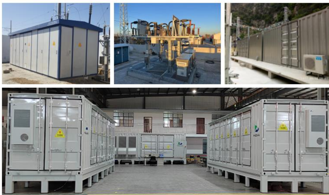
牵引供电一次设备
