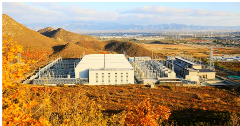
张北柔性直流电网 试验示范工程
