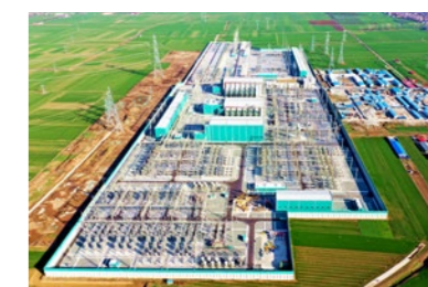
青海 - 河南 ±800 千伏特高压直流输电及其配套工程（特高压豫南换流变电站）
