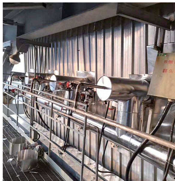
恒兴公司分区采样安装完成
