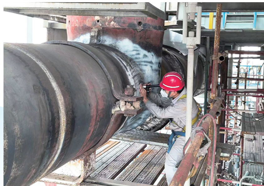
能科院开展锅炉压力管道现场缺陷分析
