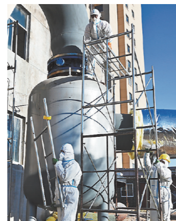
2023 年 11 月 29 日，施工人员在给承德县县城混水加压泵站内的管网安装保温层
