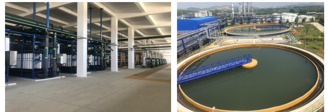
◆ 污水回用装置
