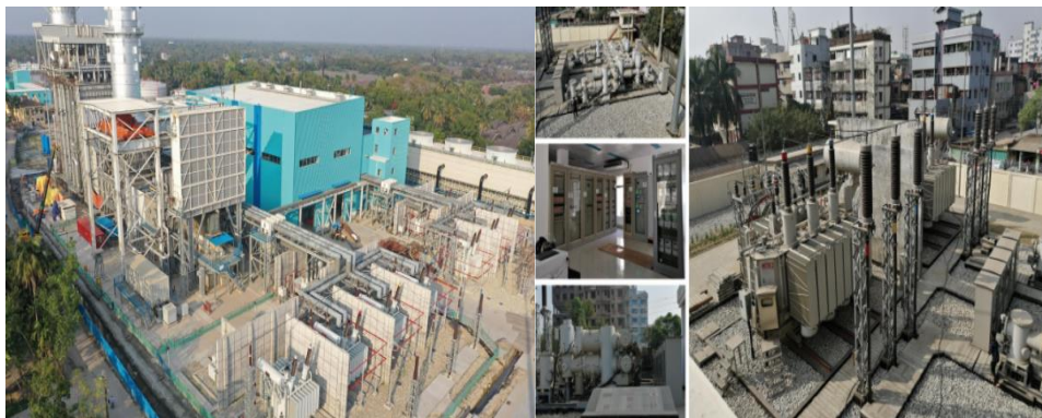
图 7：孟加拉 300MW 联合循环电站
