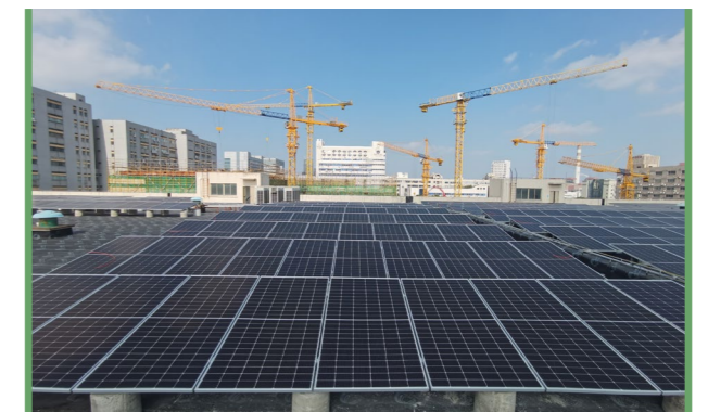
外联发公司园区屋面光伏
