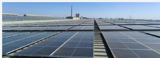
天津台玻 15.092 兆瓦分布式光伏发电项目
