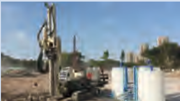
直压注入系统
