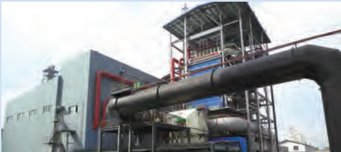
广西盛隆煤气发电现场全貌
