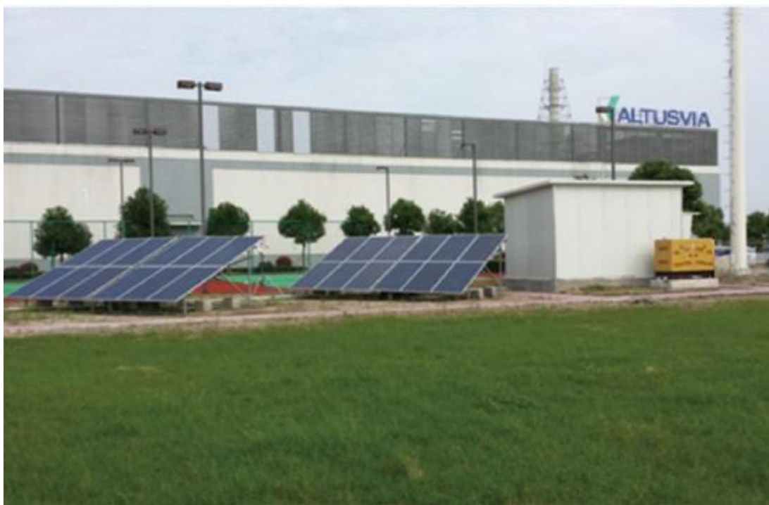
图：公司混合能源产品应用于中国电信太仓通信基站
